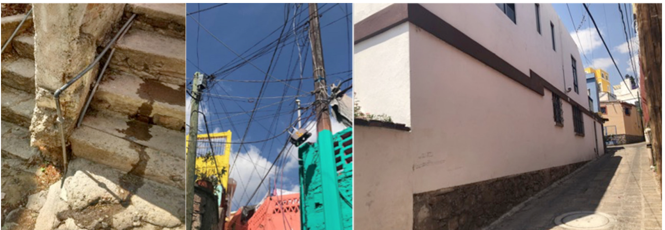
Figuras 1 (a, b y c): Estado de conservación de calles y callejones. Fuente: Fotos tomadas por estudiantes de Licenciatura en Arquitectura Universidad de Guanajuato (2019).
