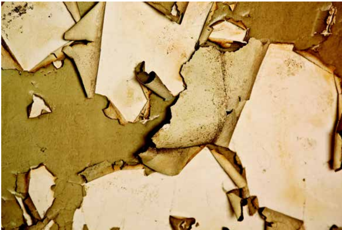
Figura 5. Detalle de muro. General León 51. Tomado del libro General León 51, registro por J. Orozco, 2011, México.
