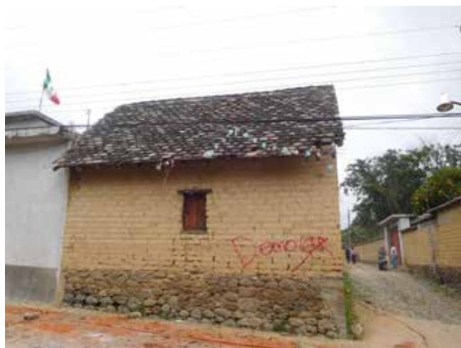
Figura 3. Identificación de vivienda de adobe clasificada para demolición. Metepec, Ocuituco. Fabiola B. Herrera Rivas. 23 de septiembre de 2017.
